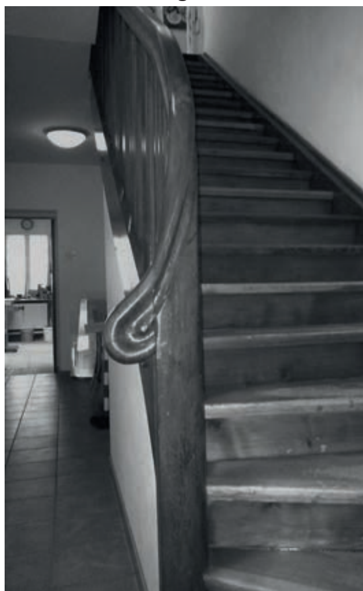
VORHER best.Treppe unzulässig
